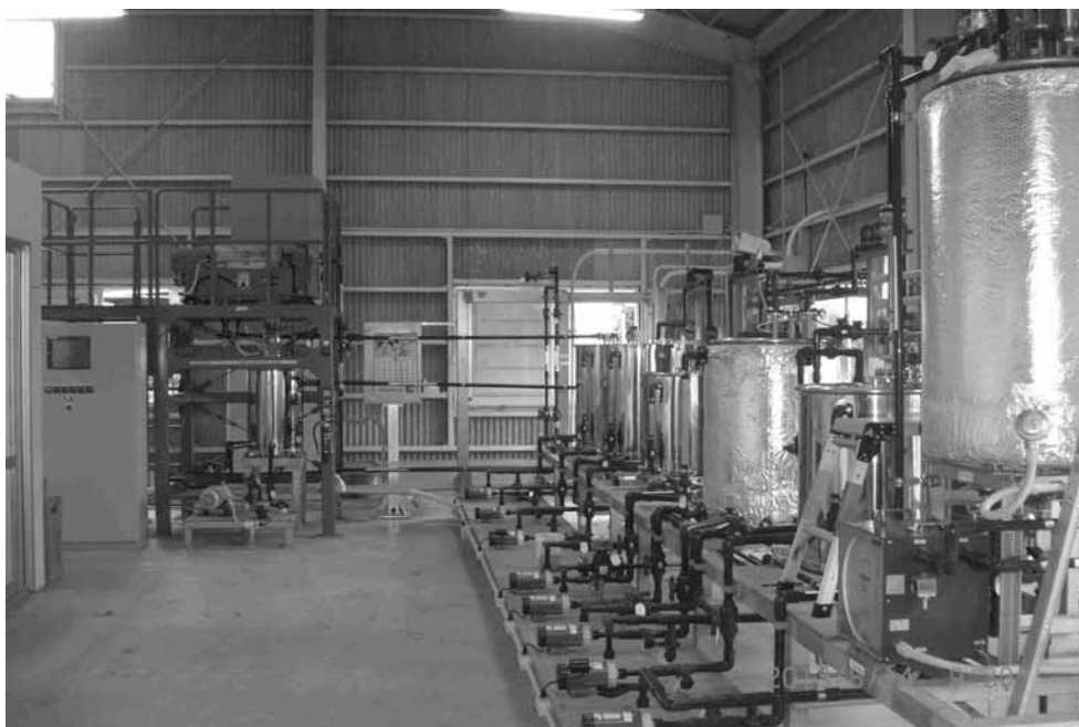
写真 1. 沖縄県糸満市に建設した 160L 糖蜜 - 発酵水素生産パイロットプラント。
